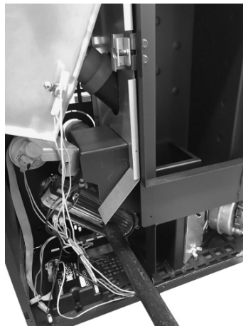
Fig. 72 - Room fan cleaning
